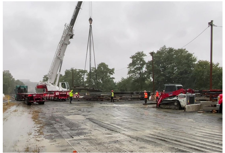
Arriba: En septiembre de 2022, los componentes de la vía cruzada de Leggett se entregaron a un patio de almacenamiento de Metro North en el Bronx, antes de la instalación en 2023. La puesta en servicio de Leggett Interlocking completo está prevista para principios de 2024.
