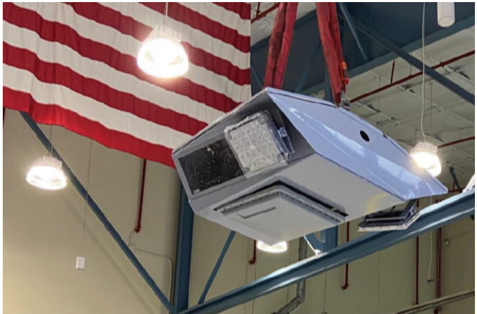
Actual image of CDBT overhead lane cluster
