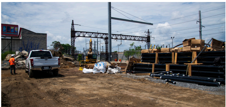
Arriba: Portales OCS nuevos y preexistentes en el emplazamiento de la futura estación de Parkchester/Van Nest Julio 2024
