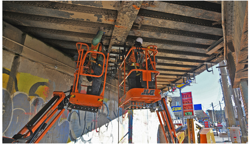
Trabajadores de la construcción de PSA preparándose para los trabajos de demolición de la superestructura del puente de la avenida Bronxdale, diciembre de 2023.
