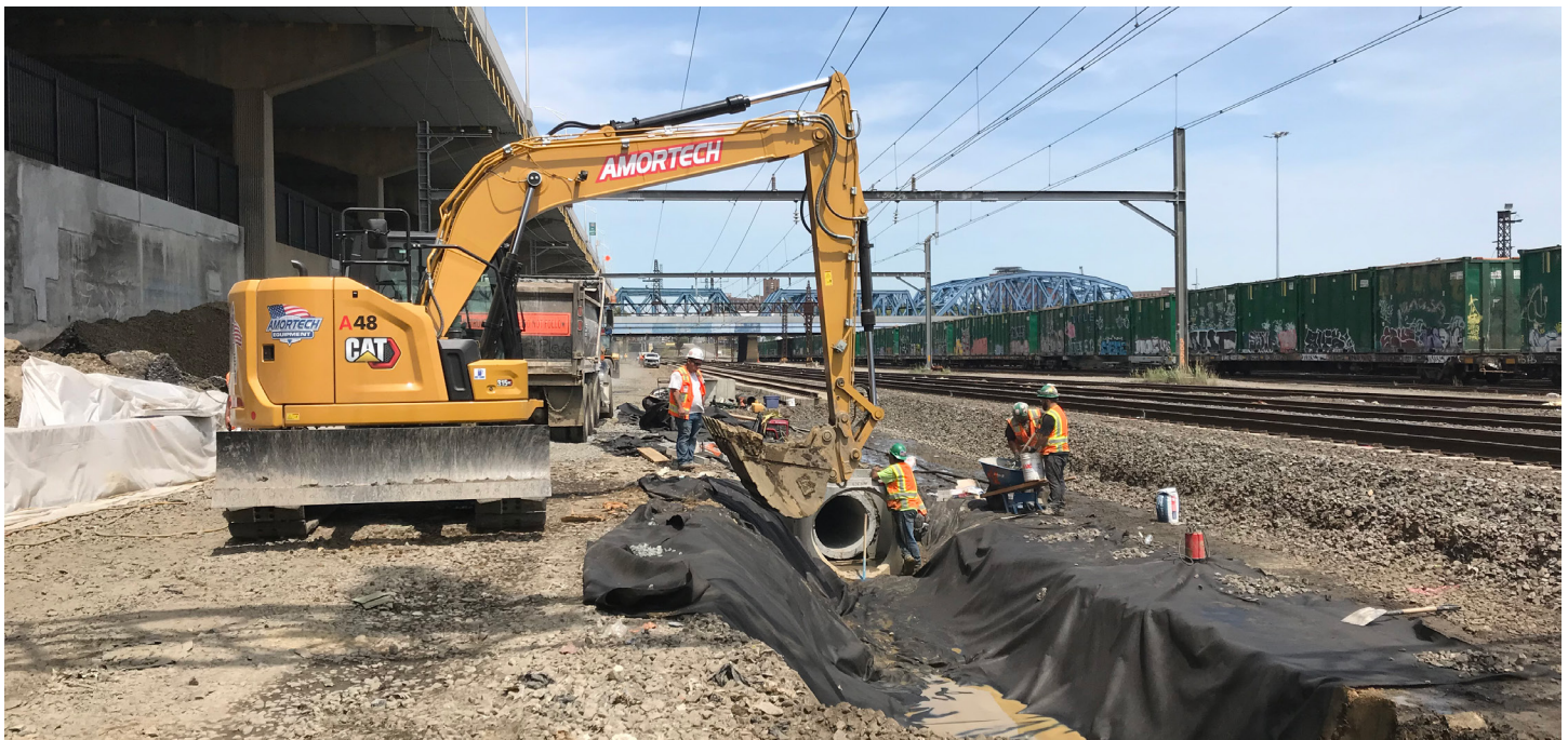
Trabajadores de la construcción de PSA instalan un sistema de drenaje cerca de la vía interconectada de Leggett. mayo 2023
